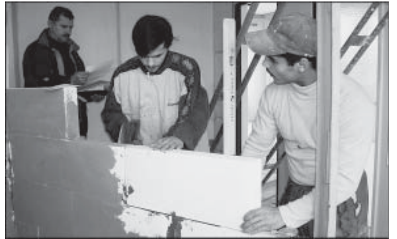
Vedoucí stavební čtyř Petr Bláha (vlevo v pozadí) dohlíží na rekonstrukci příčky, který by měla oddělit vstupní chodbu od kanceláře.
